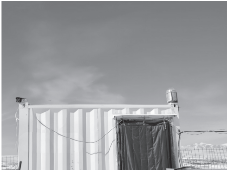
图 6 全天相机安装及监测现场 Fig. 6 All-sky camera installation and monitoring site
